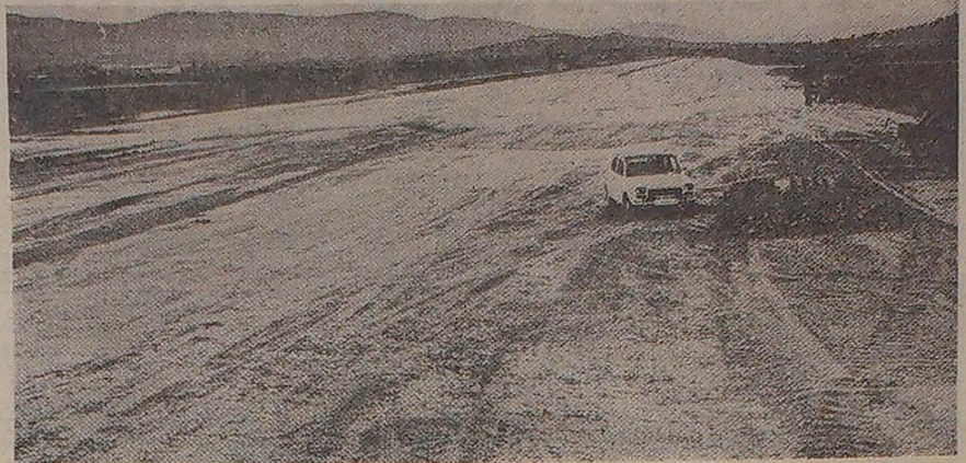
La pista será suficiente para recibir a todos los aviones comerciales existentes hoy en el mundo. Así están hoy las obras.
